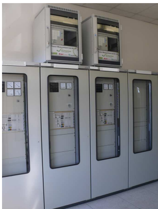
PMU Installation in Umspannwerk des Verteilungsnetzes
